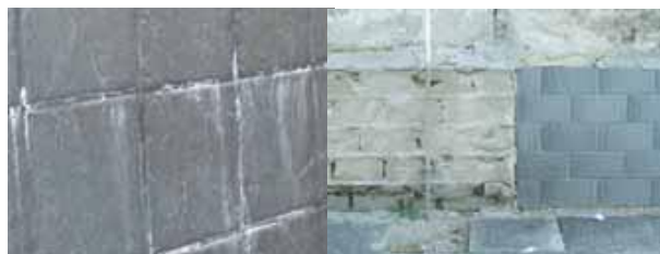
Результат: образование трещин и отслоение покрытия
