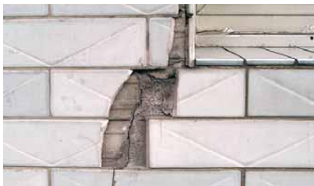
Результат: образование трещин и отслоение покрытия
